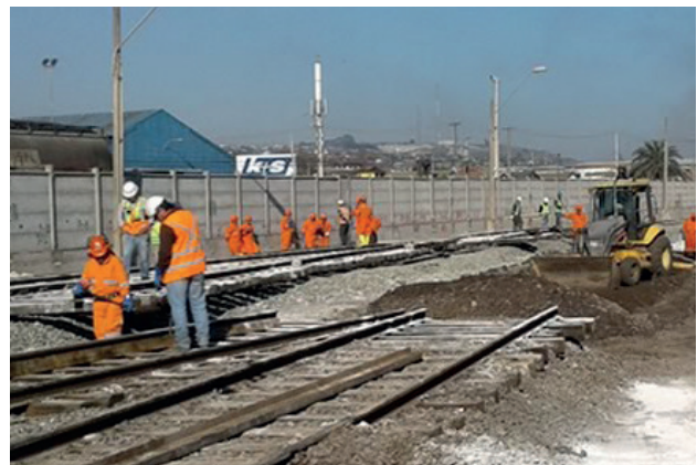
Derrame del Ácido Sulfúrico sobre la infraestructura ferroviaria al interior del terreno del terminal de descarga de Terquim.
