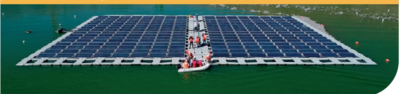
Planta fotovoltaica flotante en tranque de relave
